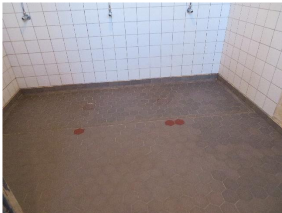
Kuva 5.15, Alkuperäiskuntoista pesutilaa, rakennusosa B
