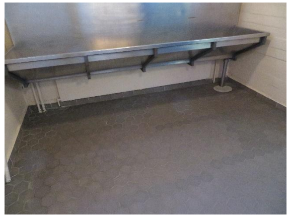
Kuva 5.16, Alkuperäiskuntoista pesutilaa, rakennusosa B
