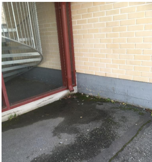
Kuva 4.31 Veden lammikoitumista syöksytorven kohdalla
